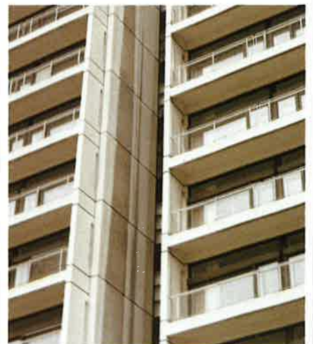
Tilsmudsning af gavl pga. skyggevirksomhed fra nabogavl.
