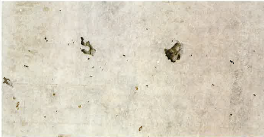
Eksempel på poredannelse hidrørende fra udstødning og vibrering.
