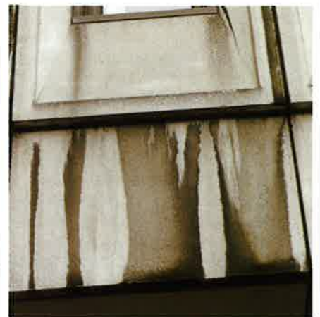
Tilsmudsningsmønster under vindue med fremspring.
