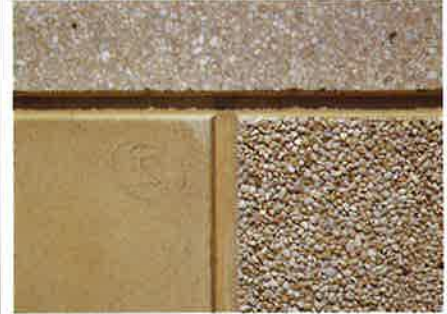
Slebet, afsyret og frilagt overflade med Glen Sanda 4/8 (skotske tilslag).
