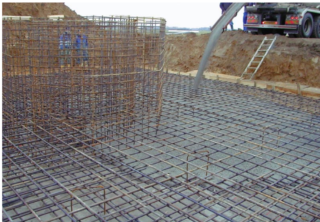
Figur 1. Udstøbning af fundament med selvkomprimerende beton, også kaldet SCC. Brug af vibrationsudstyr er ikke nødvendigt for at placere betonen korrekt, hvorfor både støj og tid brugt på selve udstøbningsopgaven kan reduceres i forhold til, hvis der var brugt konventionel sætmålsbeton.
